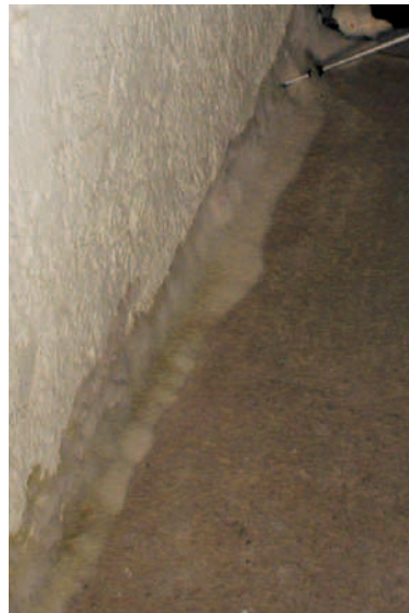
Hausschwamm in der Fuge zwischen Wand und anstoßendem Magerbetonboden
