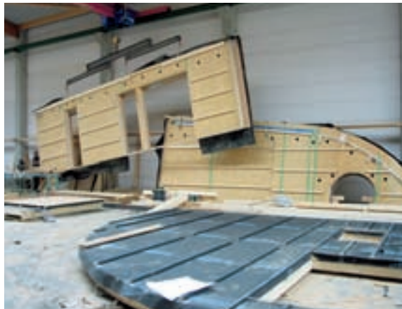
Bild links: Die Wand- und Deckenelemente wurden komplett vorgefertigt. Bild rechts: Montage des Dachgeschosses
